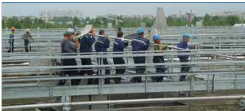
Юго-Западные очистные сооружения Санкт-Петербурга возведены в 2003-2005 годах за счет международного финансирования. Очистные сооружения одновременно с ЮИТ строили «Сканска» и «НСС».
