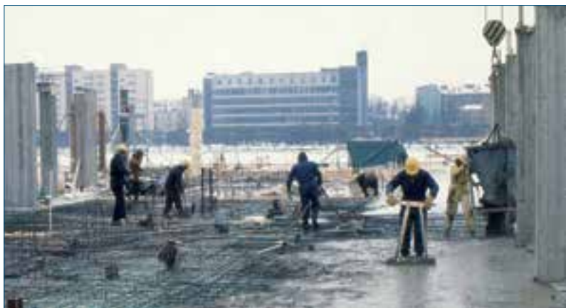
Бетонные работы при строительстве гостиницы «Дружба» в Выборге на берегу залива Салаккалаhti в начале 1980-х годов.
